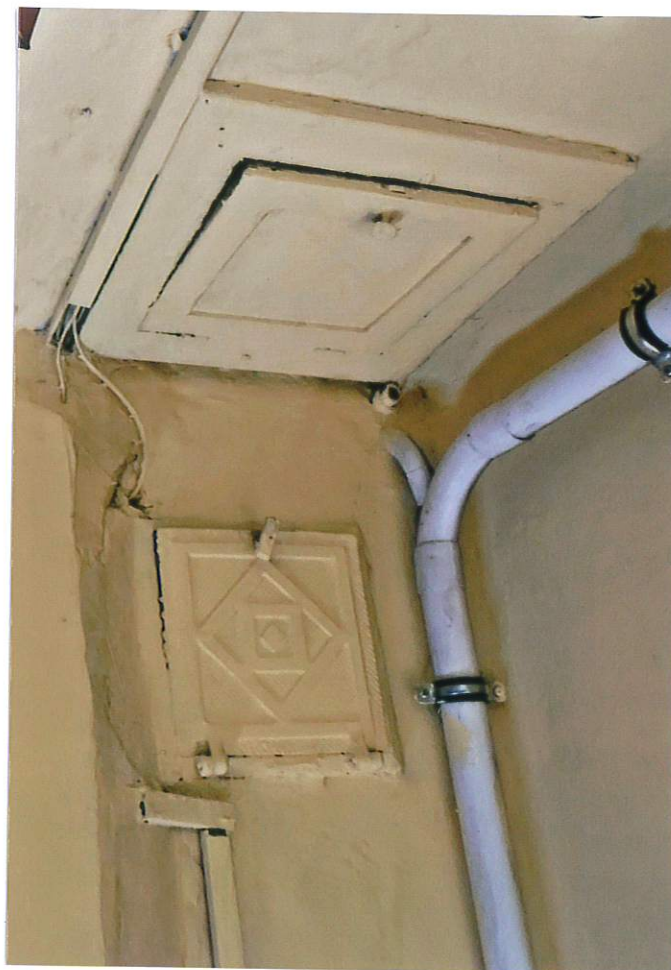
Fot. 11. Drzwiczki wentylacyjne na klatce schodowej.
